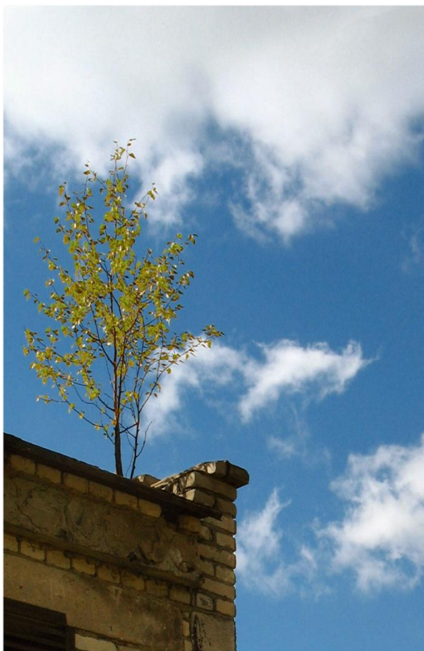
Рисунок 66 – Деревце на крыше старого здания
